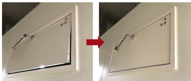
クリーンルーム差圧ダンパーの効率的開閉により新規クリーンエア送入量を削減した省エネ (富士通コンポーネント技術開発センター)
